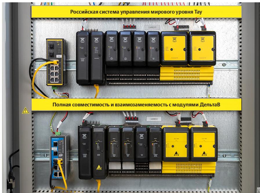
Контроллер A01 вместе с подсистемой ввода/вывода ДельтаВ на базе SLS1508
